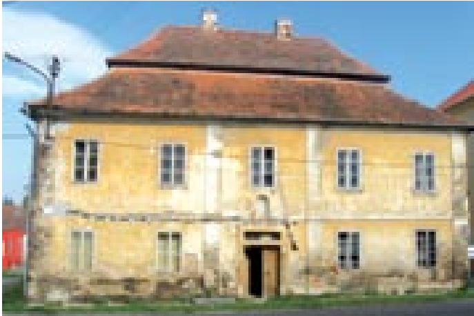
Stav v roce 2012 – před opravou.
