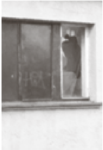
Poškozená skleněná výplň okna na Holubárně.
