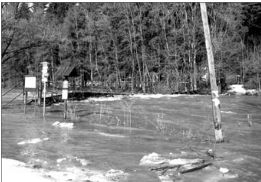
Zničená lávka ve Stvořidlech
