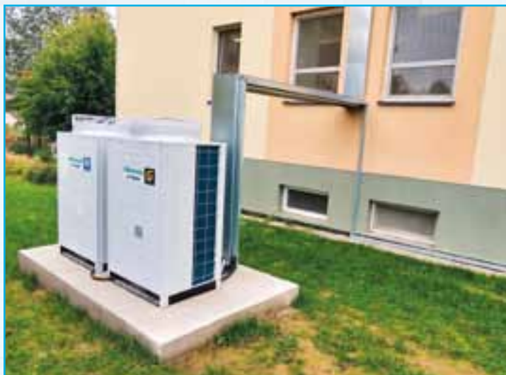
Domov pro seniory, klimatizace v půdní vestavbě
