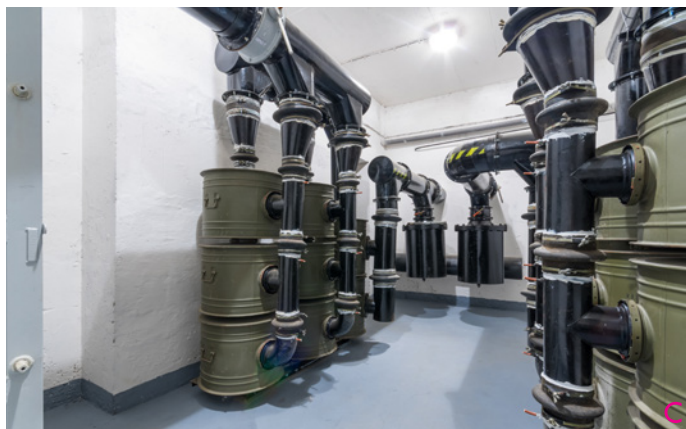
Prachová komora — k hrubému vyčištění vzduchu. C
