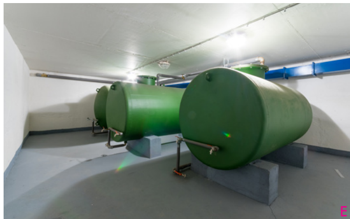
Zásobárna pitné vody. E
