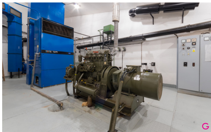
Místnost elektrosoustrojí s agregátem Škoda. G
